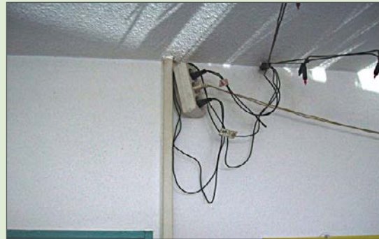
„Kabelsalat“ an der Decke
