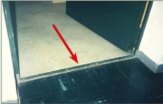
Hochstehende Schwelle in einer Tür
