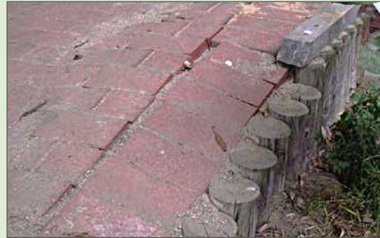
Versackter Gehweg im Außenbereich
