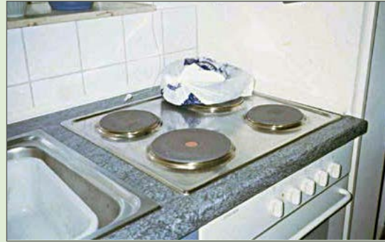
Brandgefahr bei versehentlich eingeschalteter Herdplatte
