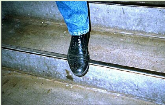
Rutschige Metallkanten an einer Treppe
