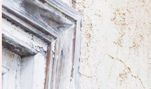
Im Putz von Wänden wurde vor 1993 oftmals Asbest verwendet.
